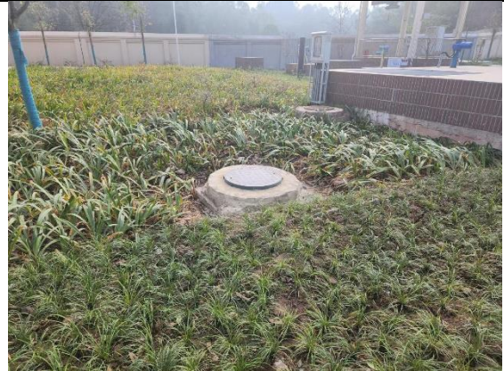
15m³ 的事故池
