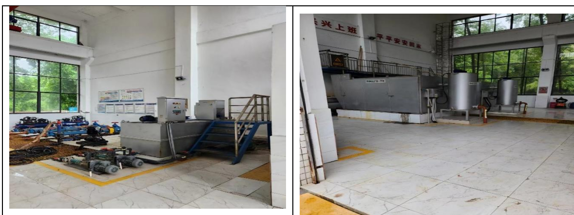
污泥脱水机房
