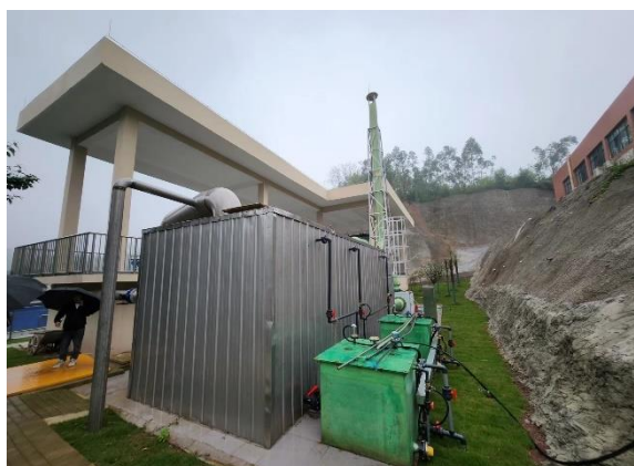
三期预处理单元及污泥处理单元废气处理设施
