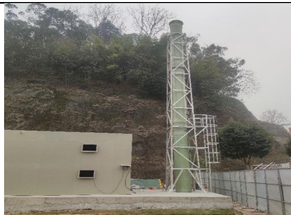
一、二期及提标改造工程的产臭构筑物废气处理设施
